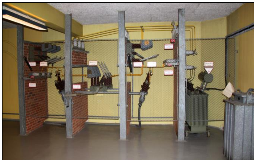
Læsø Rende Fyr, landstrømsforsyning. Fyret er forsynet med strøm via et kabel fra land.
